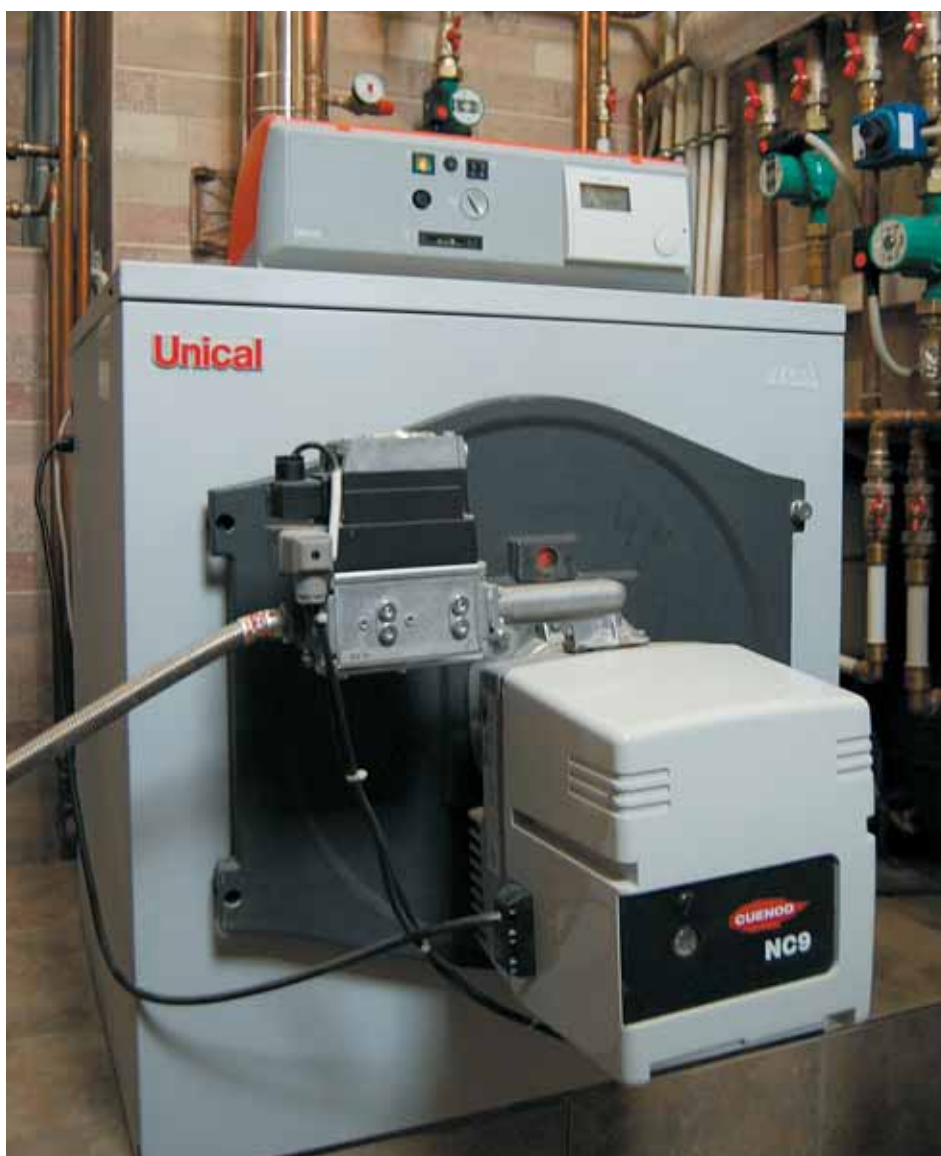
Котельная на базе котла RECAL. Монтаж выполнен ООО «ТГВ»
